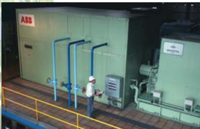
Turbogenerador de una planta de cogeneración de energía a partir de bagazo.
